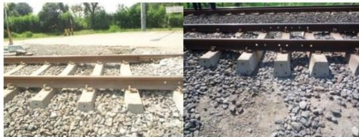
Gambar 1. Penurunan dan Penggerusan Balas di Perlintasan Sebidang dan di Lintas
